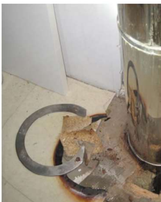
Kuva 1. Välipohjan läpi kulkevan savupiipun virheellisen asennuksen aiheuttamaa korroosioa.
