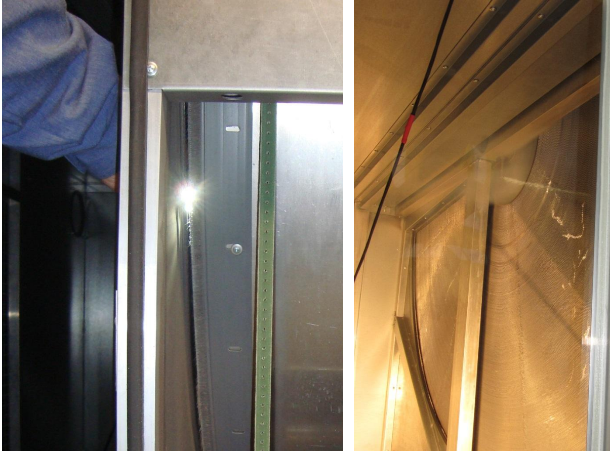
Kuva 15. Käytännön kokemuksia toimistorakennuksen pyörivän lämmöntalteenottosiirtimeen tiiviyydestä.
