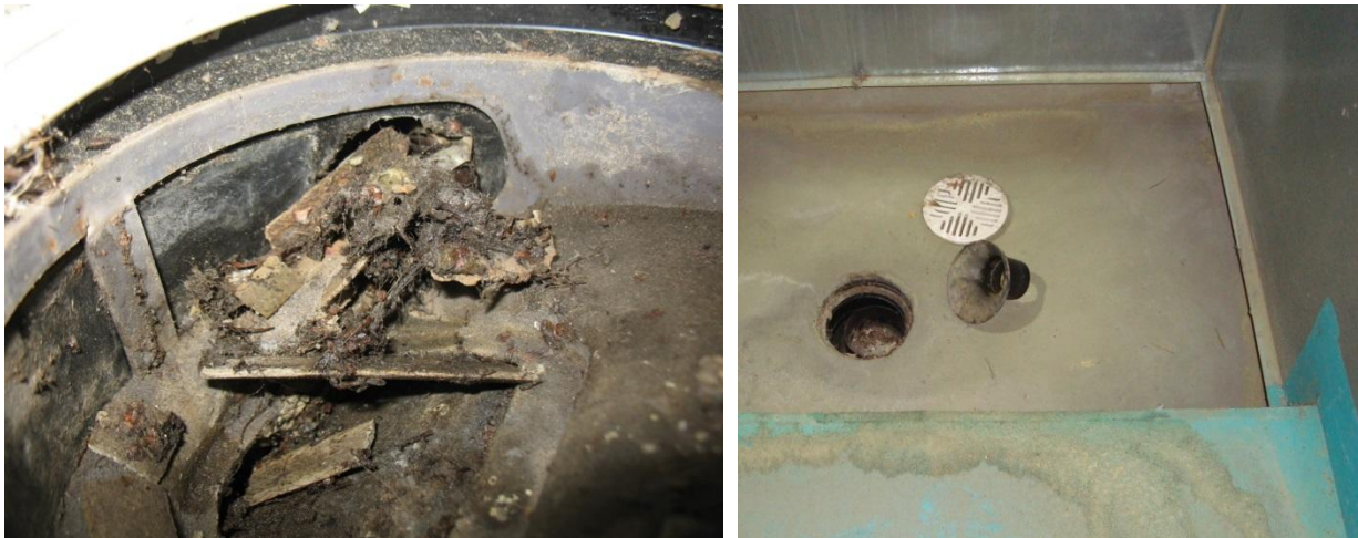
Kuva 14. Ulkoilmakammion viemäröinnin suunnitteluvirheiden ja huollon laiminlyönnin takia viemärikaasuja pääsee kulkeutumaan ilmanvaihdon mukana rakennukseen.
