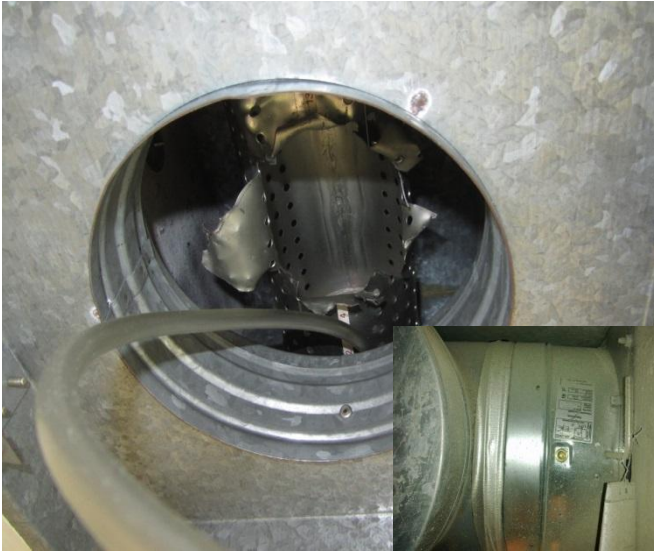
Kuva 18. Lauenneen palopellin takia puutteellista ilmanvaihtoa oli yritetty lisätä rikkomalla tuloilmalaitteen ilmavirran säätöosa.
