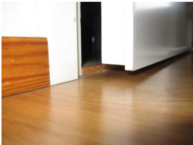
Kuva 17. WC:n siirtoilmareittinä toimiva ovirako oli peitetty kynnyksellä.
