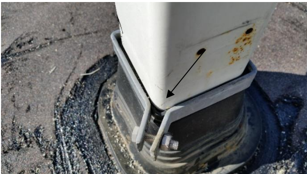
Kuva 7. Loivan katon pienikokoisten läpivientien muoto on haastava (suorakaide), jolloin vedeneristystyö edellyttää erityisiä läpivientikappaleita sekä kiristimiä.
