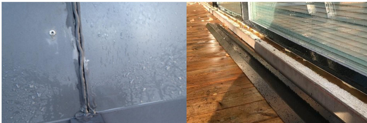
Kuva 5. Ulkoseinärakenteen vesitiiviys on merkittävästi ohuiden elastisten saumamassojen varassa ja rakenteen kuivumiskyky on heikko.
