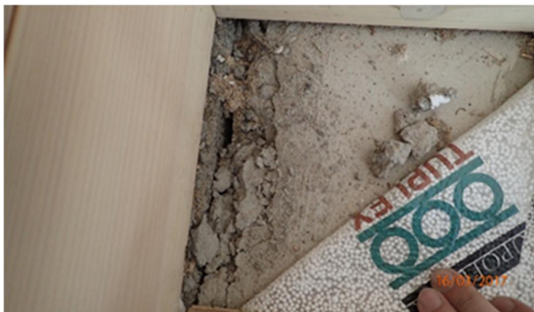
Kuva 4. Maanvarainen betonilaatta valetaan perusmuuria tai kantavia seinärakenteita vasten ilman erikseen suunniteltua tiivistämistä (esim. bitumikermiä)
