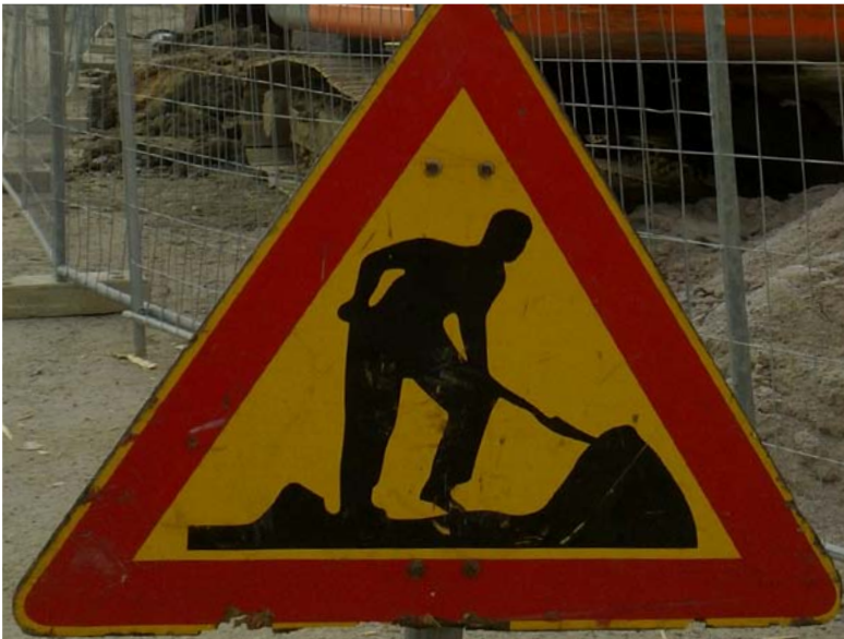
Kuva 5 Työmaa aidataan, jotta ulkopuoliset eivät pääse sinne. Lisäksi työmaasta varoitetaan ajoissa työmaakyltein.
