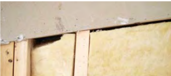
KUVA 47 Seinän villoitus samassa kohteessa: alkuperäinen villoitus ja korjattu lämmöneristys. Korjausvaiheessa työntekijöiden kanssa pidettiin laatupalaveri. Laatuvaatimukset tulee tietää ja niiden toteumisesta tulee olla kiinnostunut.
