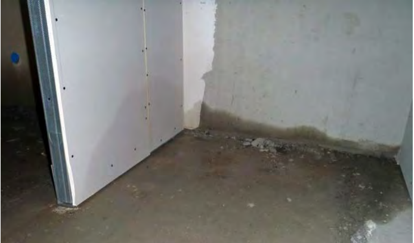
KUVA 48 Ajallinen hallinta on myös laadun hallintaa. Paras keino pitää helposti vaurioituvat sisävalmistustuotteet ja -rakenteet kuivana on ajoittaa tehtävät järkevästi. Vesikatto tulee olla valmis ennen sisätöiden aloitusta. Mikäli sisävalmistusvaihe aloitetaan ennen vesikaton valmistumista, tulee veden pääsy työkerroksiin estää muilla keinoin.
